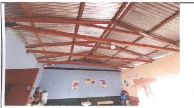
FOTO 3: TECHO CON ESTRUCTURA NO ADECUADA Y LAMINA DE CALIBRE NO RECOMENDO
