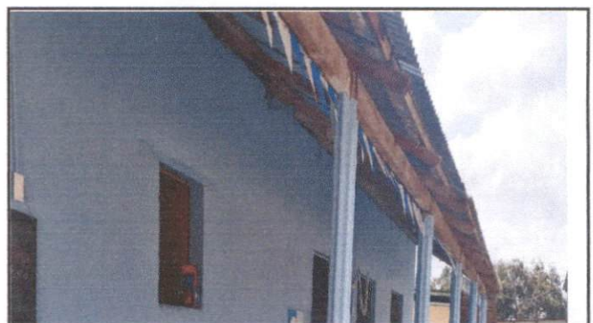
FOTO 4: TECHO DEL CORREDOR CON ESTRUCTURA NO CORRECTA
