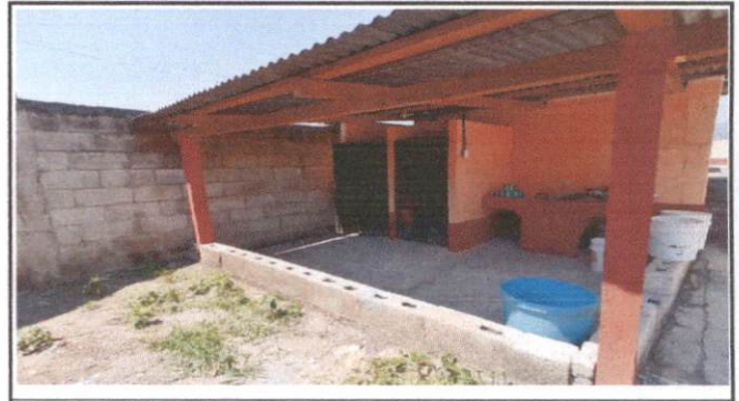
FOTO 2: TECHO DE BAÑOS CONDICIONES DE ESTRURA NO ADECUADA.
