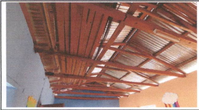
FOTO 1: TECHO EN MAL ESTADO, LAMINA Y ESTRUCTURA NO ADECUADA
