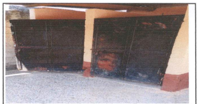
FOTO 6: PUERTAS EN MAL ESTADO,
