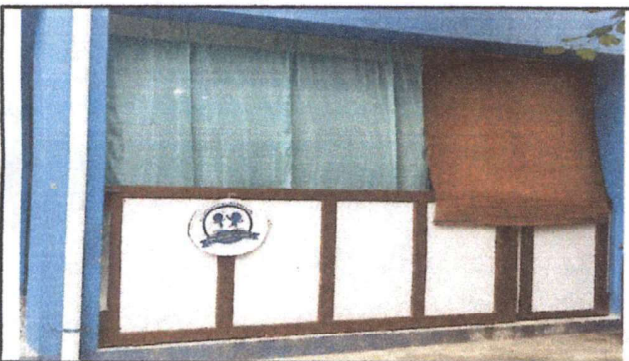
Foto 3: Por la seguridad de la dirección del establecimiento, del mobiliario, equipo y documentos de archivo es necesario realizar la reparación de muro perimetral de la dirección con block.
