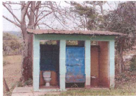
Sanitarios y lámina en mal estado
