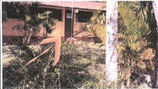
FOTO 1: MALLA EN MAL ESTADO
