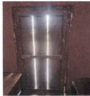
Foto 4 Puerta del salon de clase en malas condiciones.
