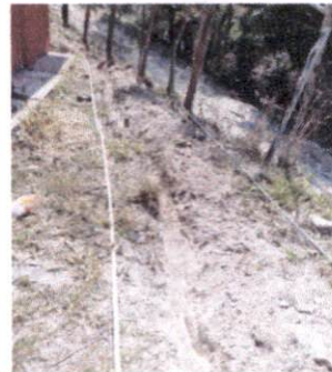
Foto 6 Muro perimetral en malas condiciones.
