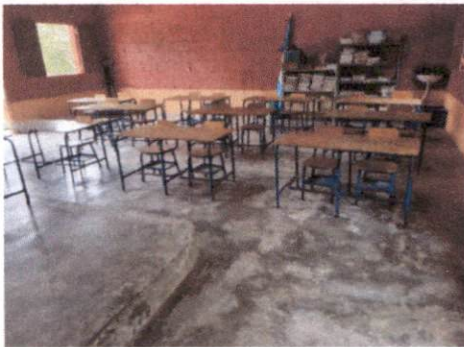
Foto 3 Piso de la escuela en malas condiciones.
