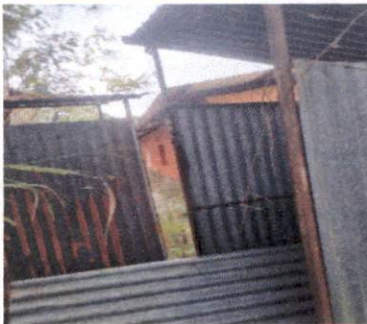
Foto 5 Baños en malas condiciones.
