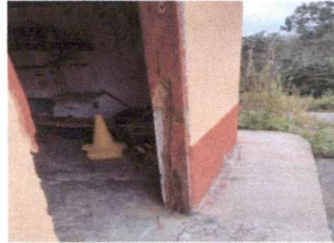
foto 2 Puertas de salon en malas condiciones.
