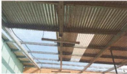
1. Cubierta de lámina: Sustitución de lámina, por lámina troquelada aluminio y zinc
