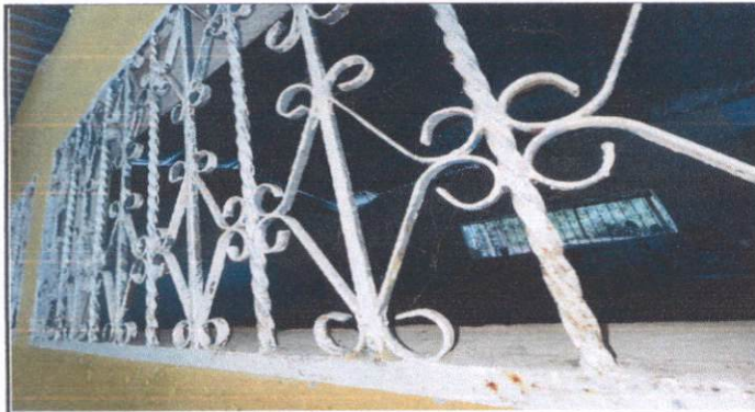
Foto 3: Balcones por reparar
