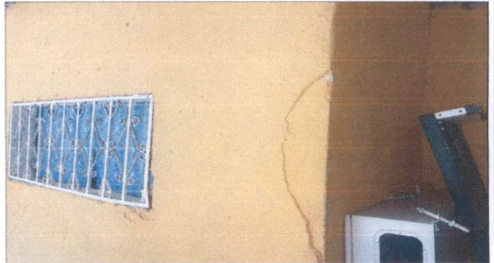
Foto 2: Area por repellar y Balcones por reparar
