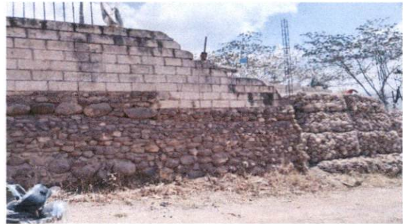
Foto 2: Muro perimetral en malas condiciones, Zona de riesgo
