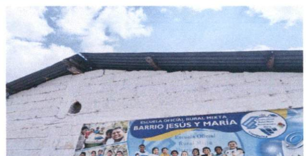
Foto 6: Lámina en malas condiciones.
