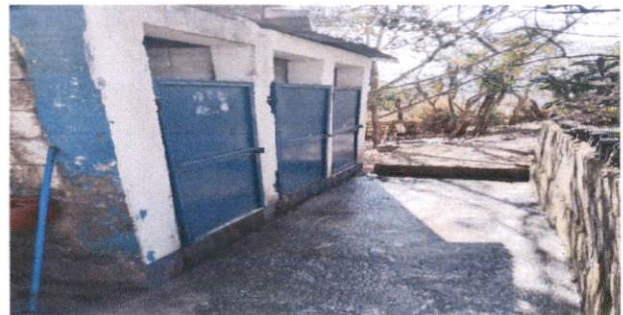
Foto 4: Puertas de baños en malas condiciones.
