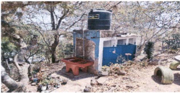
Foto 3: Tináco y red de conexión de agua en malas condiciones.
