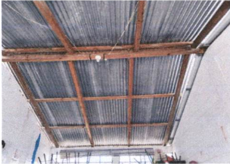
Foto 1: Techo de madera y lámina en malas condiciones
