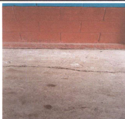
Foto 2: Grietas en las aulas
