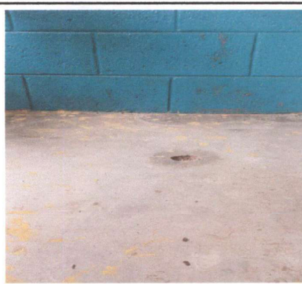
Foto 4: Grietas en las aulas
