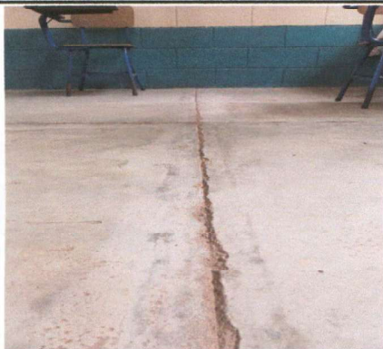
Foto 1: Grietas en las aulas
