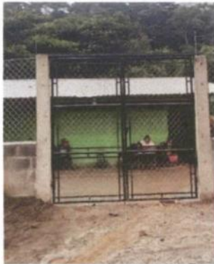
Foto 3: sustitución de portón de madera y alambre por portón de malla y tubo galvanizado
