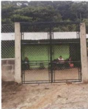
Foto 3: sustitución de portón de madera y alambre por portón de malla y tubo galvanizado
