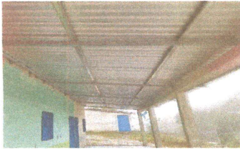
Foto 3: Sustrucción de Lámina y madera
