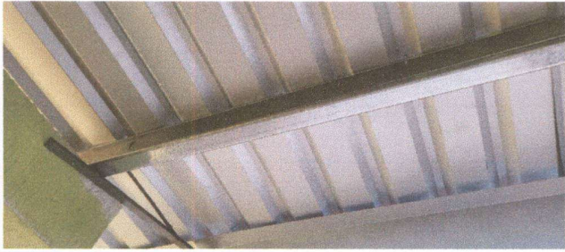
Foto 1: SUSTITUCION DE COSTANERAS EN MALESTADO
