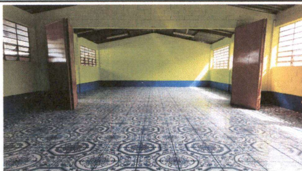
Foto 5: Pintura en pared.
