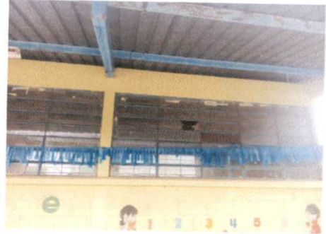
Foto 8: Sustrucción de Balcones
