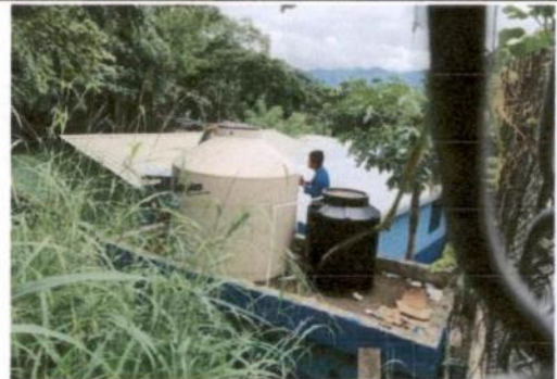
Foto 10: Depósito de agua
