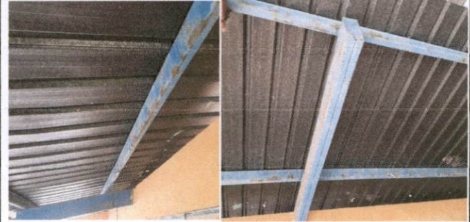
Foto 2: Costaneras en mal estado
