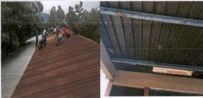
Foto 1: Cubierta de lámina en mal estado
