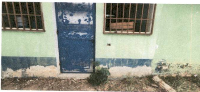
Foto 3: Puertas y paredes en mal estado.
