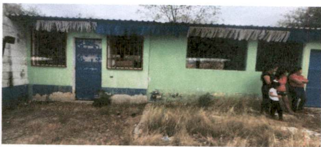
Foto 1: Paredes del aula de preprimaria agrietadas y en mal estado, se observan miembros del Consejo Educativo realizando recorrido para priorizar necesidades.
