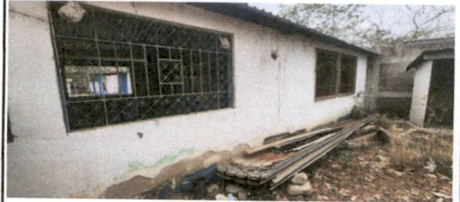
Foto 2: Se observa pared trasera del aula agrietada y con repello en mal estado.
