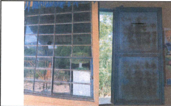
Foto 3: Mantenimiento y sustitución de ventanas en mal estado.
