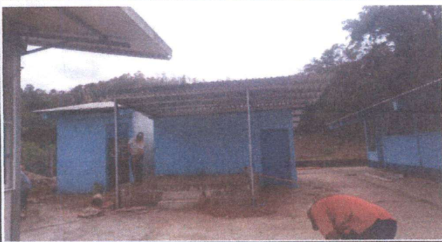
Foto 1: Instalación de estructura metálica y ampliación de laminado en área de escenario.
