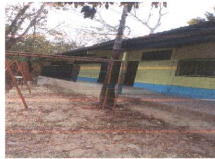
Recogimiento de agua pluvial con tubo de 3 pulgadas
