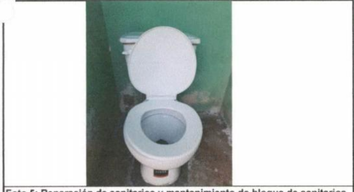
Foto 5: Reparación de sanitarios y mantenimiento de bloque de sanitarios para colocación de cisterna.
