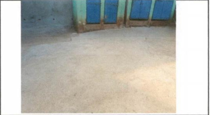
Foto 2: Mantenimiento de losa de patio, para evitar el avance de grietas en el mismo.
