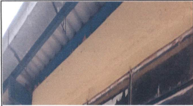
Foto 7: Canales y bajada de agua pluvial
