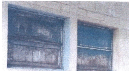
Foto 10: Mantenimiento a estructura de metal de ventana Mantenimiento de barandas de metal
