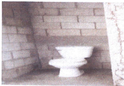
Foto 5: Servicios sanitarios y sus accesorios.
