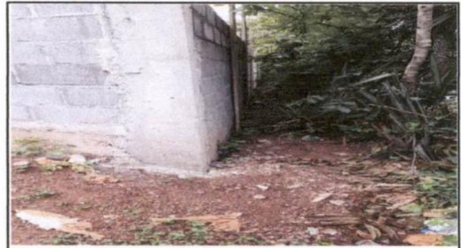
Foto 4: Sustrición de muro perimetral
