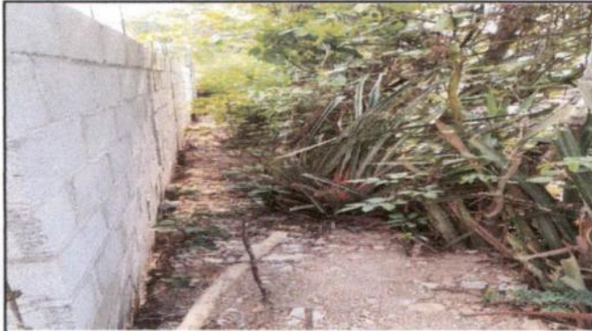
Foto 1: Sustrición de muro perimetral
