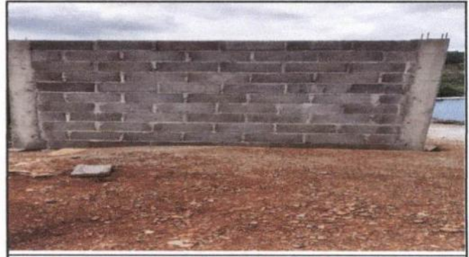
Foto 2: Sustrición de muro perimetral
