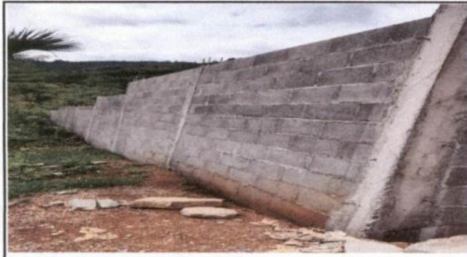
Foto 3: Sustrición de muro perimetral
