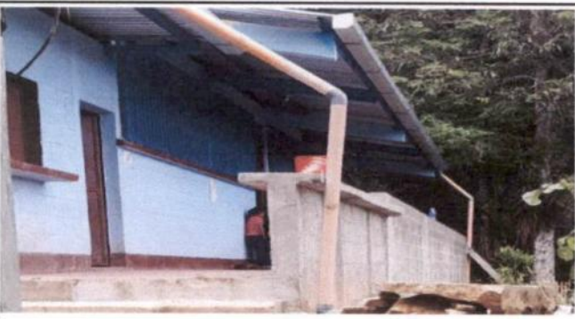
Foto 3: Canales y bajada de agua pluvial
