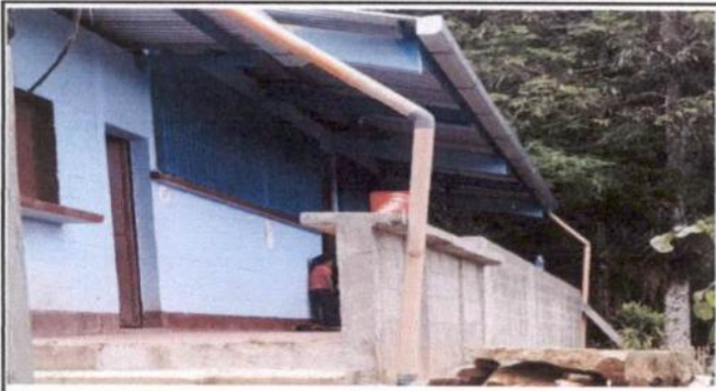
Foto 3: Canales y bajada de agua pluvial
