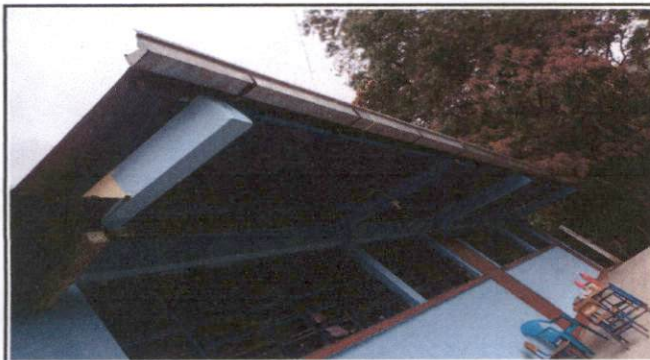
Foto 3: Canales y bajada de agua pluvial
