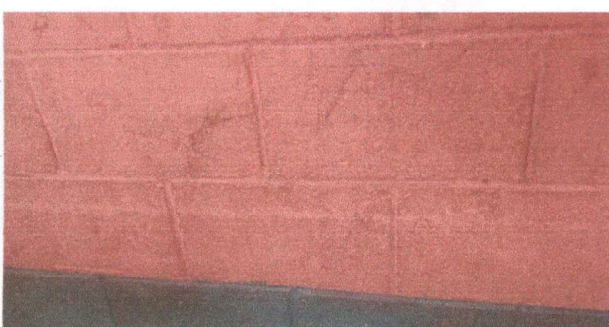
Foto 5: DAÑOS EN LA PINTURA DEL INTERIOR DE AULAS
