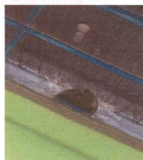
Foto 2: DAÑOS EN LOS VIDRIOS DE LAS VENTANAS
