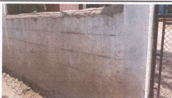
Foto 11: DAÑOS EN EL MURO PERIMETRAL EXTERIOR
