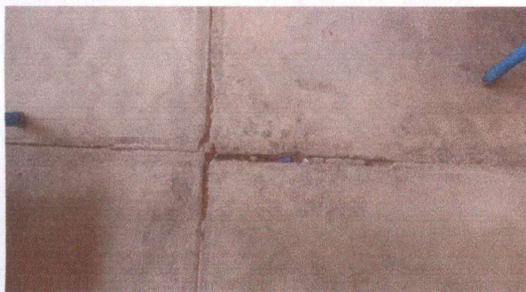
Foto 1: DAÑOS EN EL PISO DE LAS AULAS
