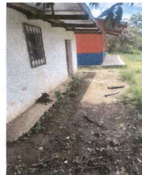
Foto 4: Torta de concreto en patio.
