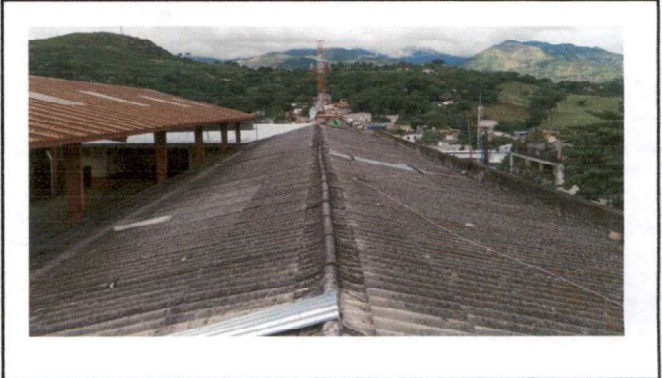
Foto 2: Techo en pésimas condiciones.
