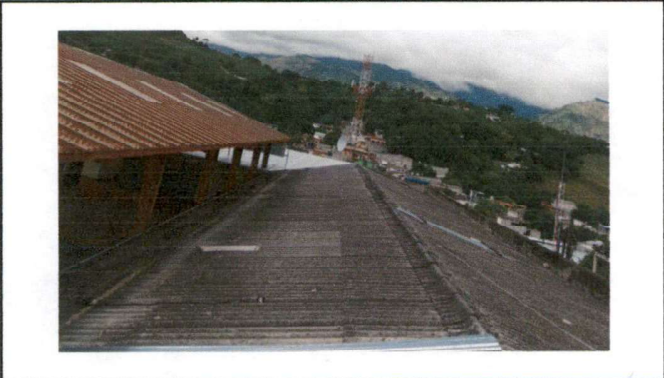
Foto1: Duralita en mal estado.
