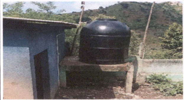
Foto 4: Depósito de agua de 2,500 lts.
