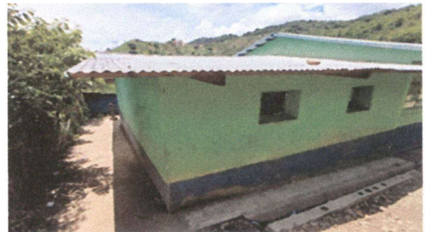
Foto 2: Sustitución de ventanas de madera por ventanas de metal mas vidrios y balcones de metal.
