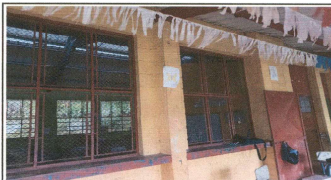
Foto 4: Pintura en muro exterior en inferior
