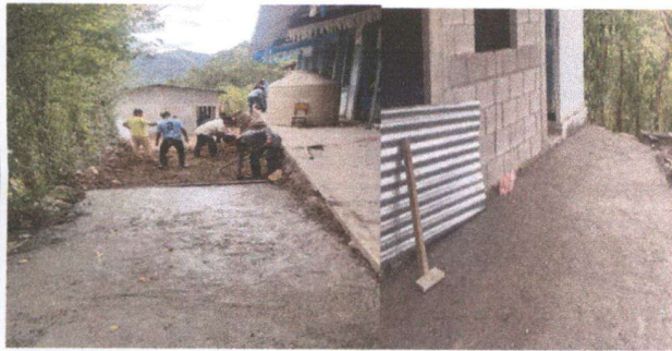
Foto 3: torta de cemento en patio de la escuela
