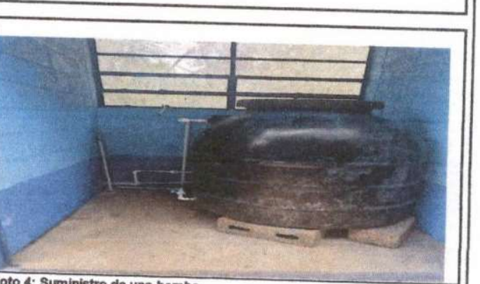
Foto 4: Suministro de una bomba.
