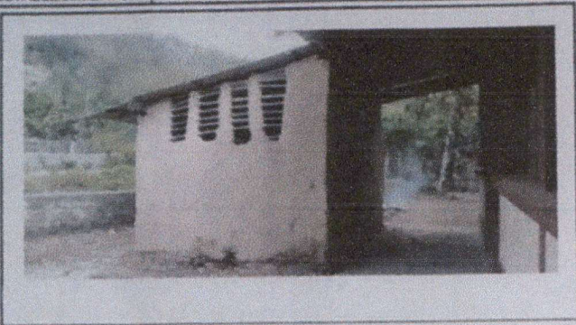
Foto 1: Sustrucción completa de paredes de cocina
