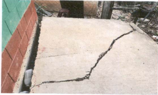
Foto:7 Hendidura banqueta
