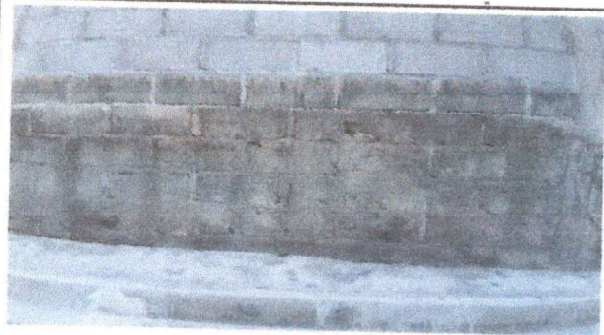
Foto 4: La parte de abajo del muro perimetral deteriorado
