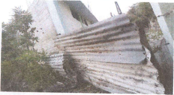
Foto 3: Muro de contención en mal estado
