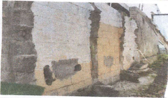
Foto 1: Muro de contención en mal estado
