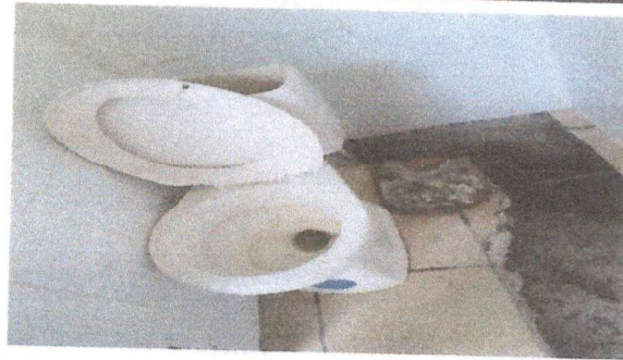
Foto 2: Taza del sanitario mal estado
