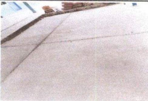
Foto 5: reparación de piso de torta de concreto (incluye un tramo de banqueteta)
