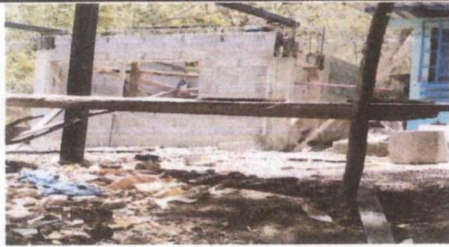
Foto 1: sustitución de estructura de soporte (madera) por metal. (estructura y cubierta metálica)
