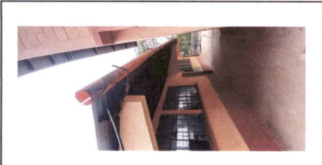
Foto 5: Canales en mal estado.
