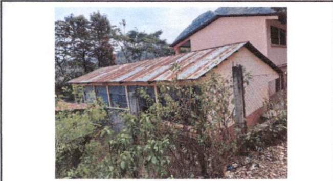
Foto 1: Techo de lámina en mal estado.
