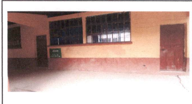
Foto 2: Puertas de ingreso deterioradas.
