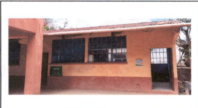
Foto 3: Ventanales en mal estado.
