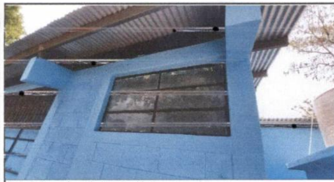
Foto 5: Espacio sellado entre lámina y pared.
