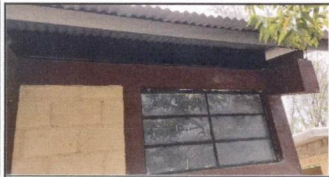
Foto 5: Espacio sellado entre lámina y pared.
