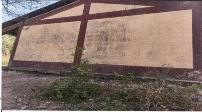
Foto 1. Banqueta en mal estado.
