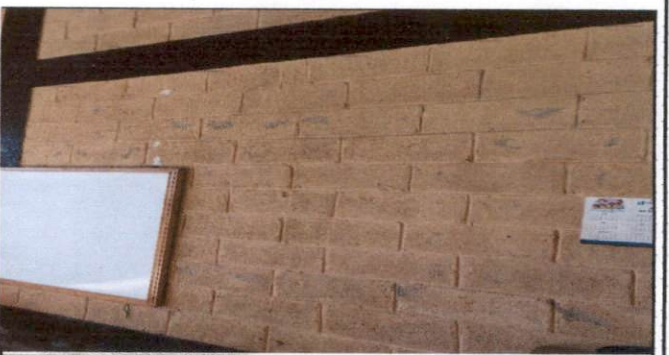
Foto 6. Filtración de humedad en paredes.
