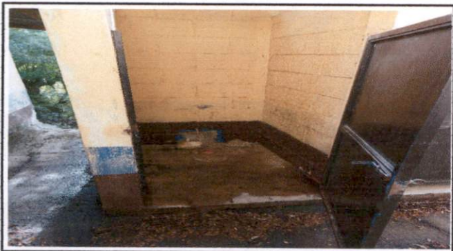
Foto 3. Baños en mal estado y se robaron uno
