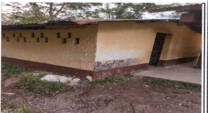
Foto 4. Tecno de Cocina en mal estado.
