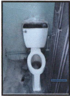
Foto 1: Los baños están inservibles el agua no se va por la tubería
