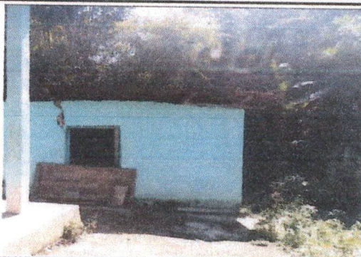
Foto 2: Cocina en mal estado
