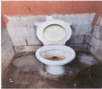
Foto 7: Sustitución de inodoros porque se encuentran en mal estado. Fuera de servicio.
