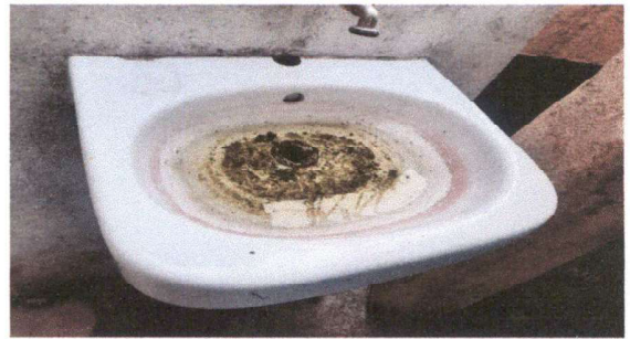
Foto 8: Sustitución de lavamanos, porque se encuentran en mal estado y fuera de servicio por estar tapados.
