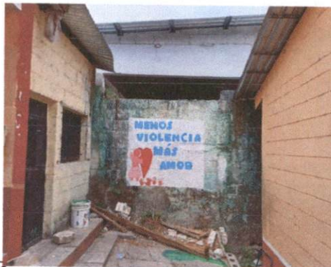
Foto 2: muro perimetral en mal estado, ampliará la altura
