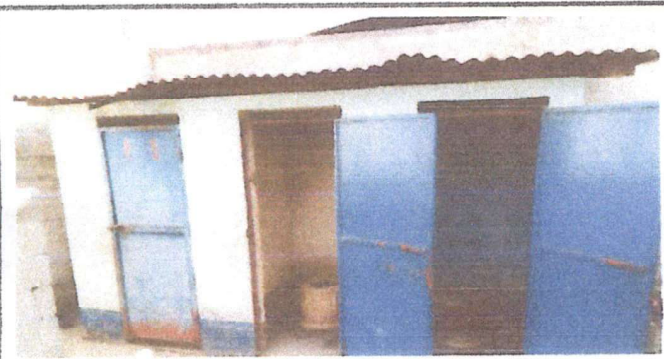
Foto 3: Letrinas en mal estado
