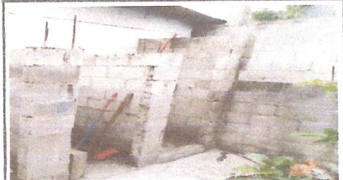
Foto 4: Ducha en mal estado
