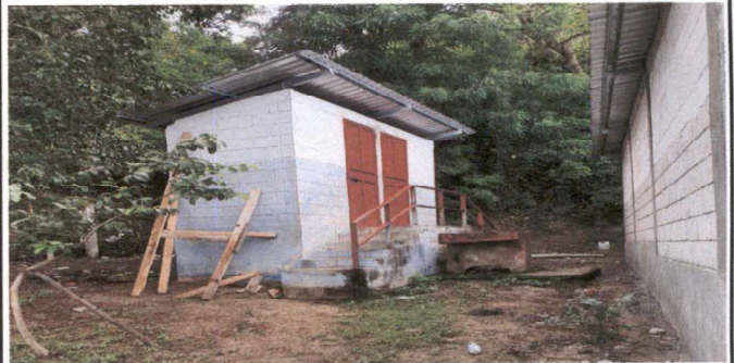
Foto 4: con necesidad de aplicar pintura en interior y exterior.
