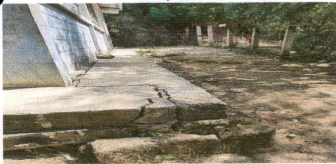
Foto 11: Banqueta de Concreto con necesidad de reparación.
